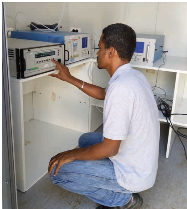
Technicien s'assurant du bon fonctionnement des appareils de mesure du SO 2 de la station Artchipel de Basse-Terre
