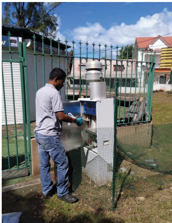
Technicien récupérant les échantillons sur le préleveur HAP de la station Artchipel à Basse-Terre
