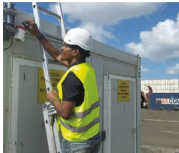
Installation de capteurs sur le site d'EDF Jarry Nord
